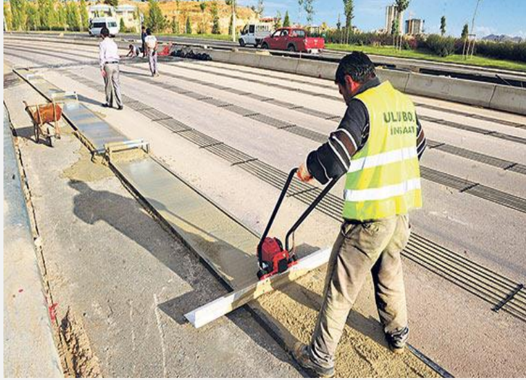
Şekil 7: Ankara Protokol Yolu Üzerinde İmalatı Yapılan Elektrikli Isıtma Sistemi
